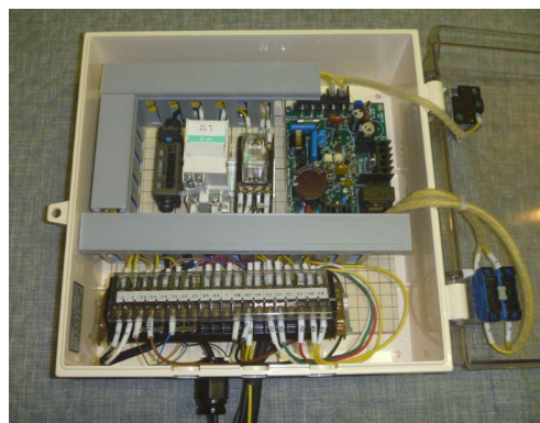
システム制御盤
